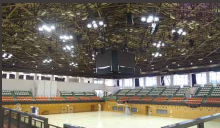
天井に「VRX900 Series」のアレイ計10本▶と「AM5212/95」計4基を設置し、会場全体を均一にカバーしている。
