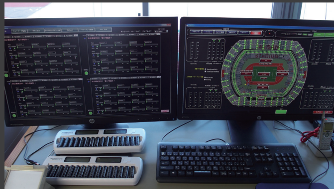
▲[Audio Architect] で構築したコントロール画面。一元管理しているので ミキサーの出力からアンプまで全体を監視し、操作できる。
