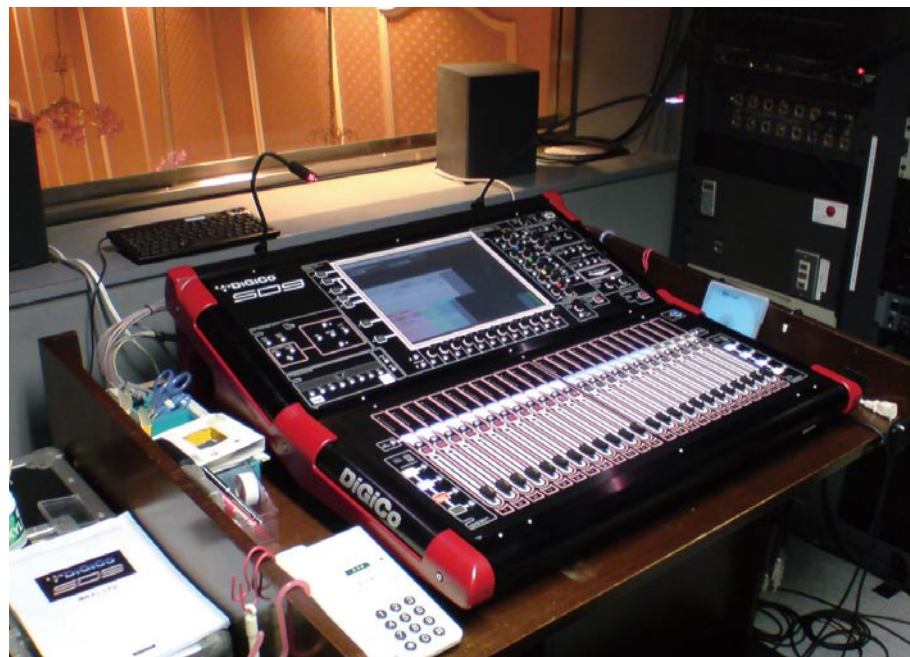
小ホールの音響調整室に設置された DiGiCo “SD9”
