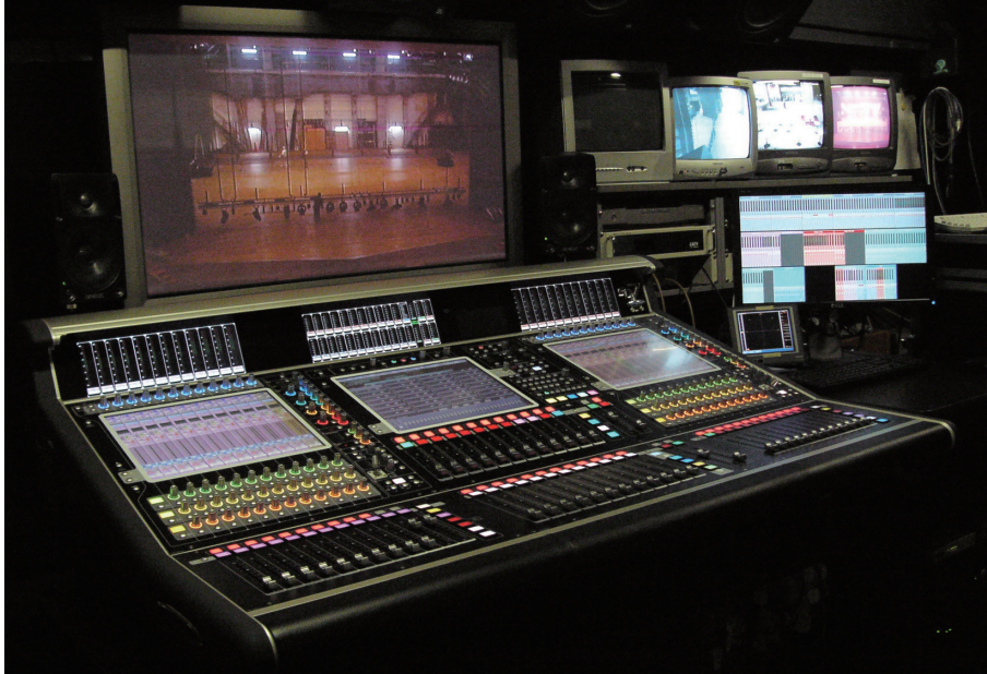
大ホールの音響調整卓に採用された DiGiCo “SD7”
