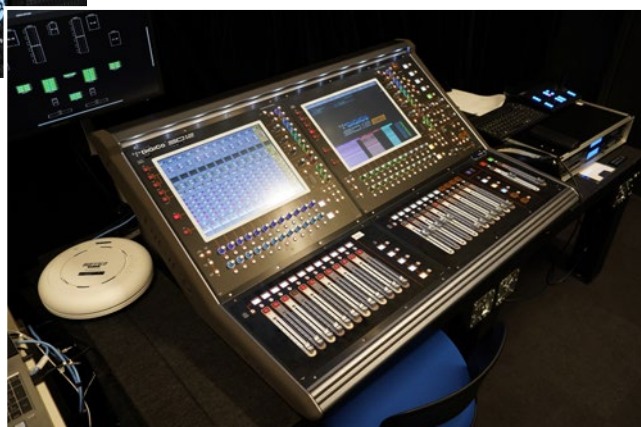
音響調整室に設置されたハウス・コンソール、DiGiCo SD12-96
