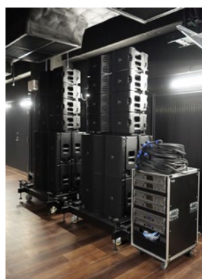
主に平土間時に使用される仮設スピーカー VTX-V20。 4/2 構成で 4 セット用意されている。台車に乗っていて自由に移動が可能
